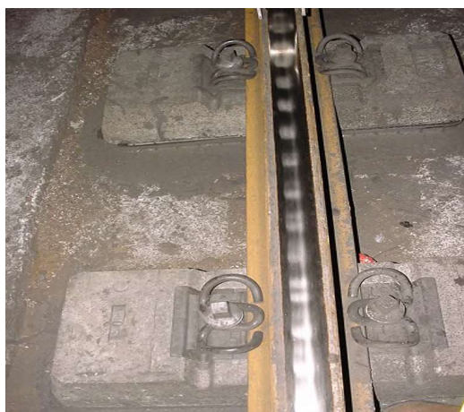
Figure 5 : Usure ondulatoire sur une section de rail.
