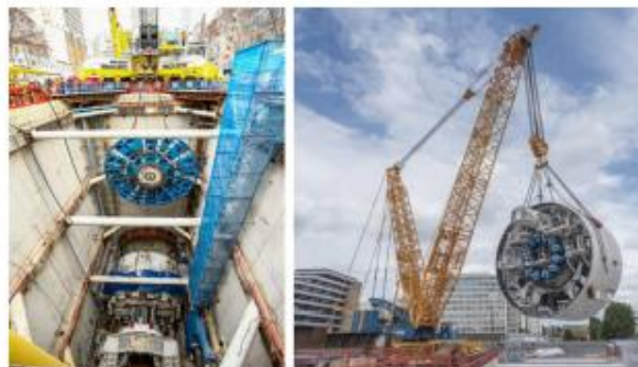
Photo d'un puits tunnelier et des équipements de levage nécessaires à la sortie des équipements (SGP, 2019)
