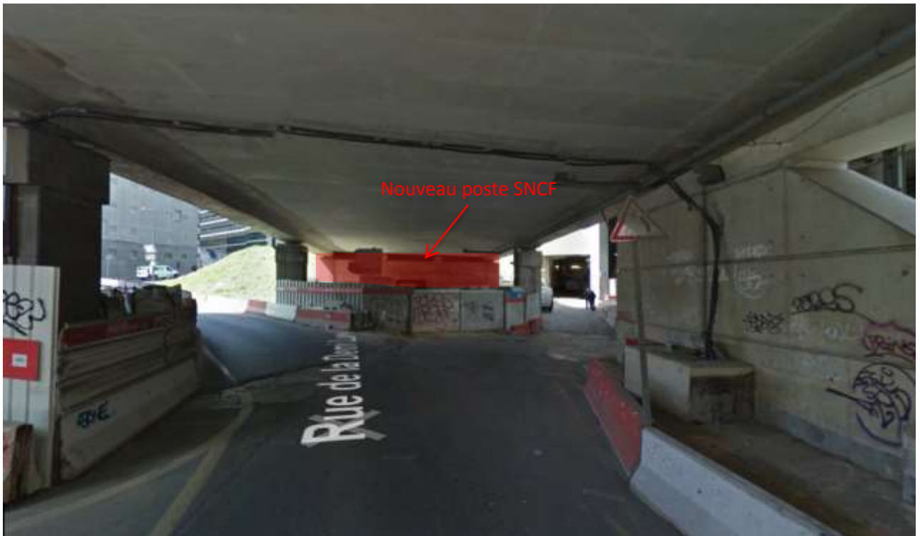
Photographie prise sur la route de la Demi-Lune permettant de figurer l'emplacement de la culée creuse Source : Google Street View
