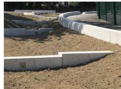
Référence de muret de bief en granit à Livry-Gargan (93) [projet en cours de réalisation, avant plantations et pose des crépines de protection des ajutages]
