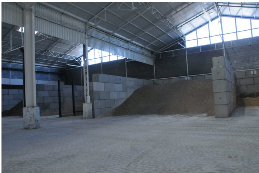
Photo : Vue des cases de granulats de l'installation de Nanterre
