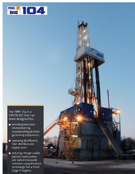
Figure 1 : appareil de forage SMP104 qui pourra être utilisé pour réaliser le doublet géothermique
